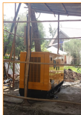
Um den Abschaltungen vom Strom zu begegnen hat das Center einen neuen Generator installiert. Da die Dieselskosten hoch sind kann das nur eine Zwischenlösung sein. Ein eigener Transformator für die Schule würde eine langfristige Verbesserung bedeuten. Strom wird für die Hostienbäckerei und das Essenkochen gebraucht.
